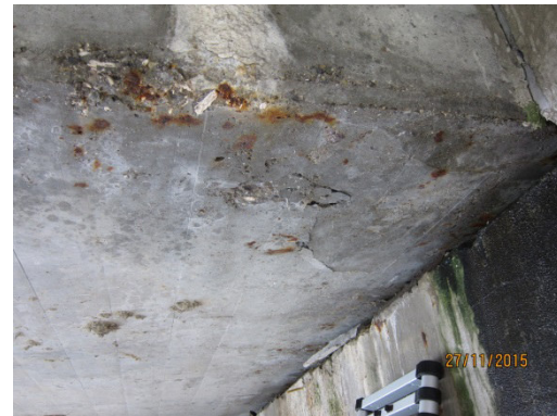
N°10 RG/ TRAVÉE 1 A PROXIMITÉ CULÉE FISSURATION / CONCRETION ET CORROSION
