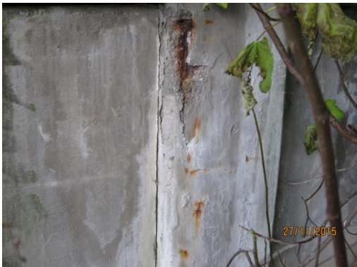
N°5 CULEE RG/ CORROSION D'ARMATURES ET ÉCLATEMENT DE BÉTON
