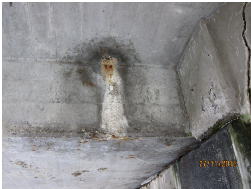
N°9 TRAVÉE 1 / CONCRETION CALCAIRE ET ARMATURE CORODEE
