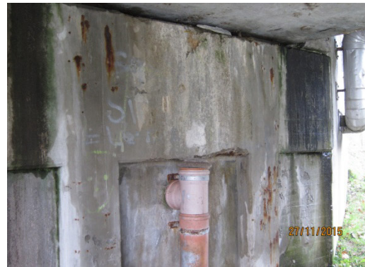
N°6 CULEE / CORROSION + VENUE D'EAU
