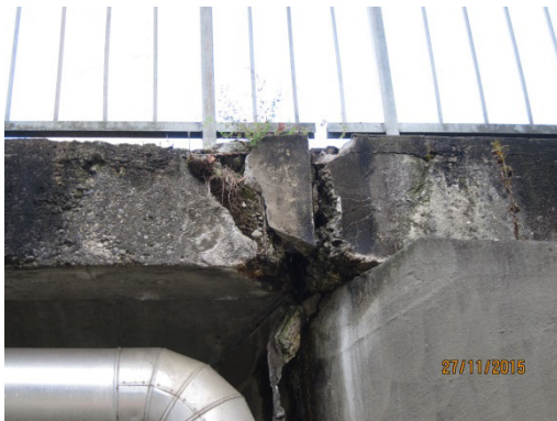
N°11 TRAVÉE 1/ DÉSAGRÉGAGE DU BÉTON AU DROIT DU JOINT DE CHAUSSÉE
