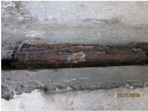
N°7 CULEE RG / APPAREIL D'APPUI TÔLE CORRODEE
