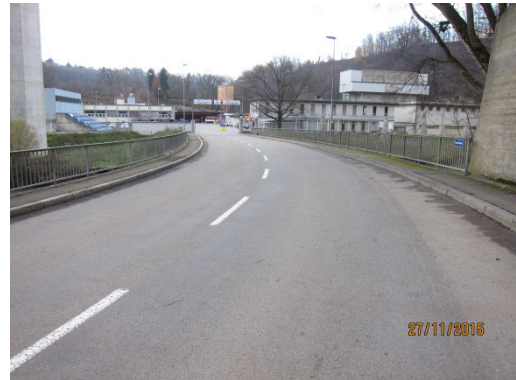
N°2 CHAUSSÉE/ VUE D'ENSEMBLE À L'AVANT
