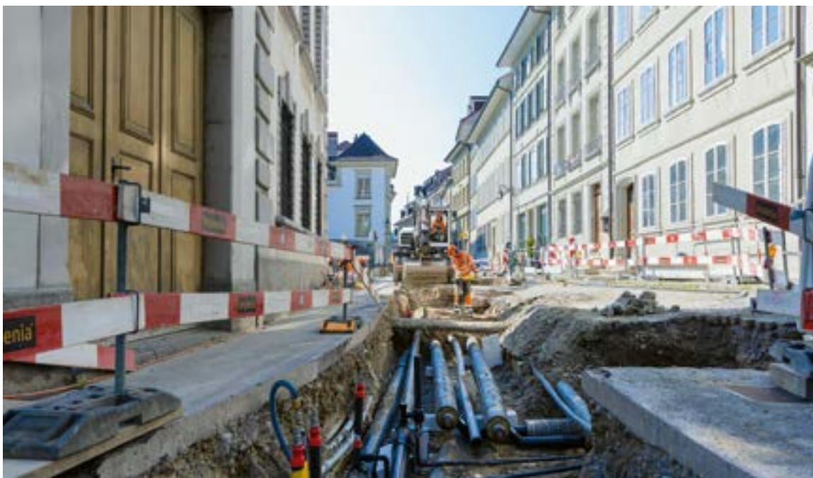
Installation du réseau de chauffage à distance à la rue Pierre-Aeby en 2021 © STEMUTZ Installation des Fernwärmennetze in der Rue Pierre-Aeby im Jahr 2021 © STEMUTZ
