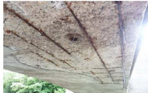
Armature apparente, fortement rouillée
