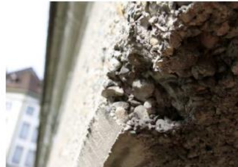
Eclatement du béton du bord des voûtes
