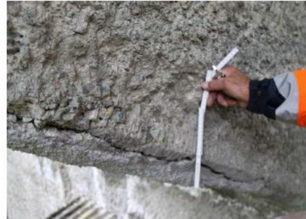
Fissure, détachement du béton projeté
