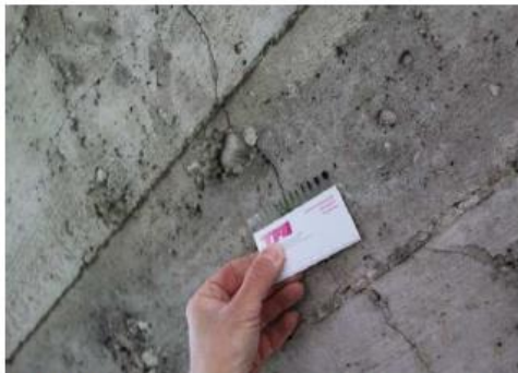
Fissures au milieu de l'intrados
